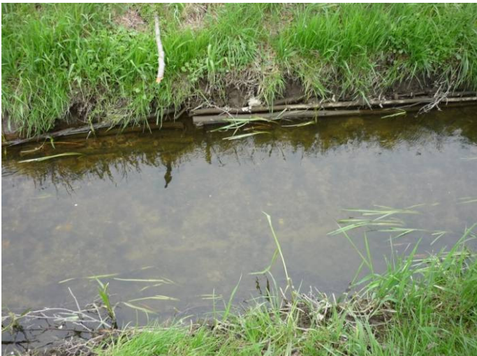
Abbildung 10: Faschinen zur Böschungssicherung nach 20 Jahren Nutzungsdauer an der Aller bei Groß Bartensleben
