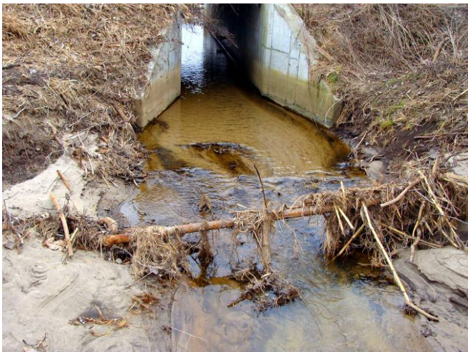
Abbildung 20: Unnatürlicher Sandtrieb und hohe Schwallabflüsse infolge überhöhter Niederschlagswassereinleitung aus Verkehrsflächen, Wolpgraben bei Kressow
