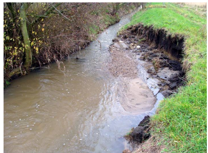
Abbildung 21: Seitenerosion, Wolpgraben bei Dornburg
