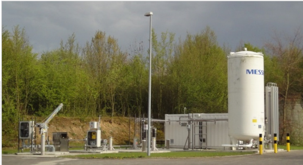
Kläranlage Bad Sassendorf (Oxidation mit Ozon)
