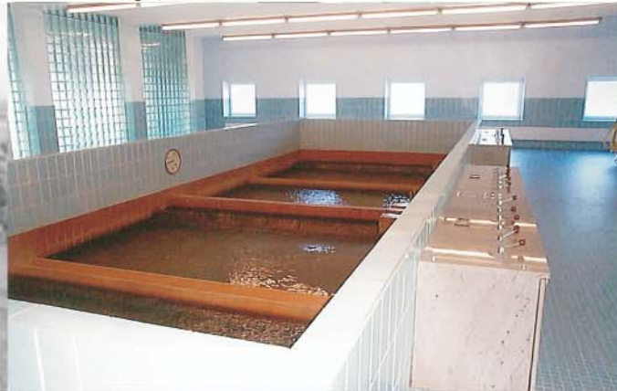
Foto: WBV Wingst; Filterbecken
