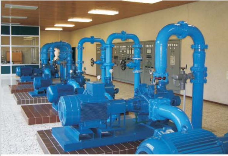
Foto: WAV WEM Nord Wasserwerk; Reinwasser-Pumpen
